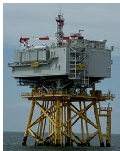
La sous station électrique.
